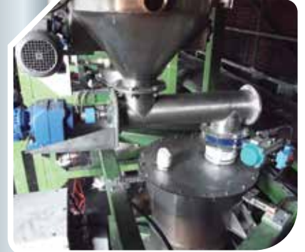
Big bag boşaltma, tartım ve dolum sistemi Bigbag discharging and weighing system.
